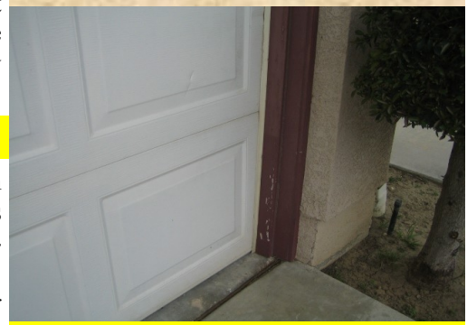
Garage Door Frame-Peeling Paint
